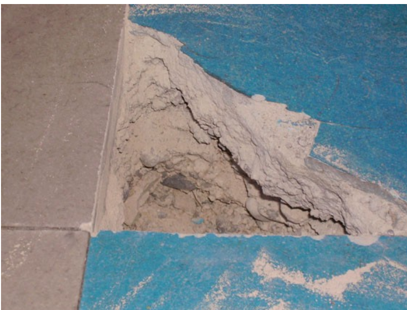
Foto 4 Il saggio eseguito in corrispondenza della fessura nella sala esposizioni che ha evidenziato la presenza della fessura anche nella cartella di sottofondo, la stratigrafia è del tutto uguale a quella dell'altro saggio.
