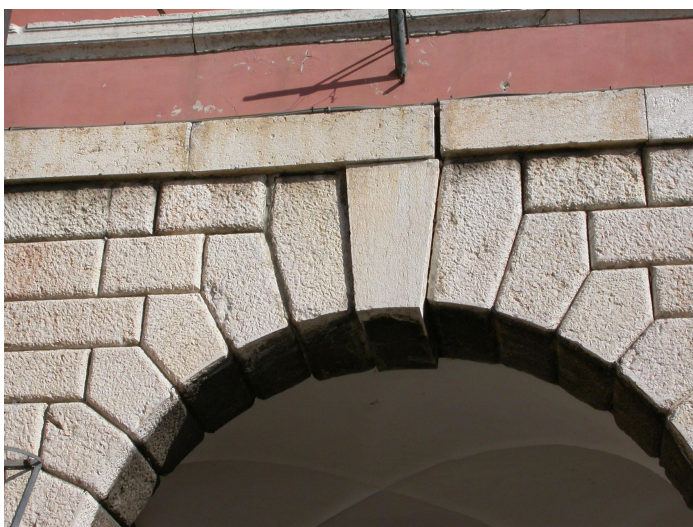
Foto 5 Vista della facciata principale con il concio che ha evidenziato lo spostamento maggiore.
