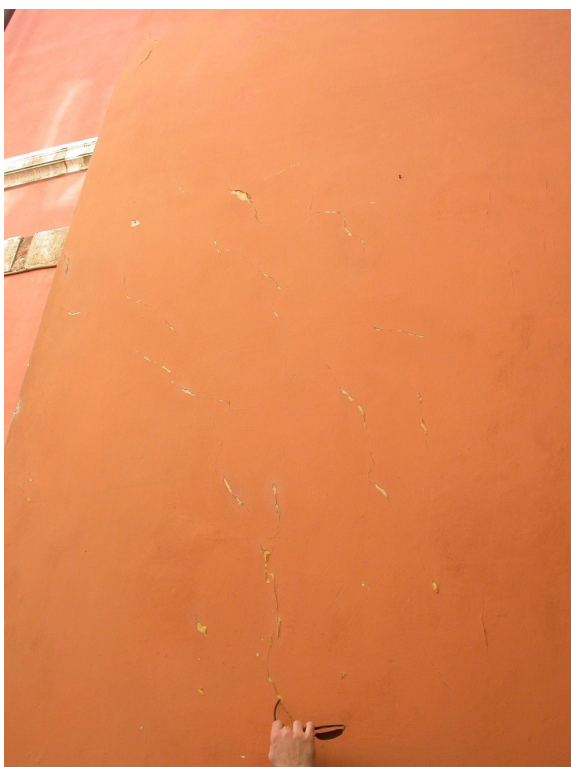
Foto 6 Facciata opposta a quella principale con in evidenza le fessure di tipo capillare che devono essere sigillate
