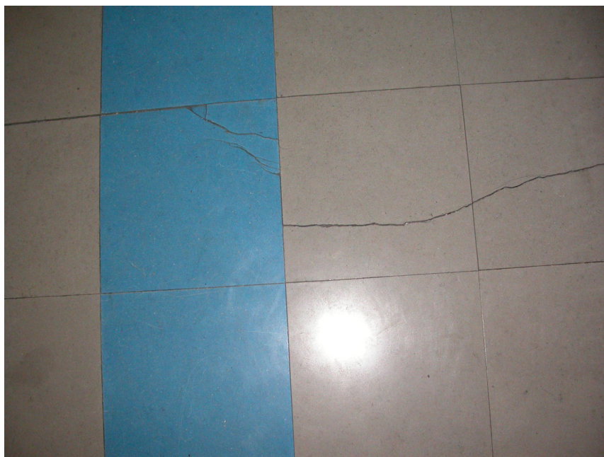
Foto 5 Particolare della fessura trasversale alla sala che si è aggravata a seguito dell'evento sismico
